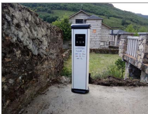
Imagen 13. Punto de recarga tipo poste instalado en Porto, Zamora.
